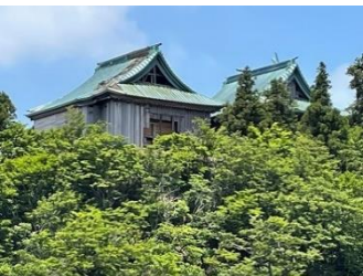
上宮、距離をとって見ると美しいが、よく見ると壊れた所が見えます
