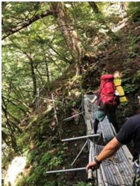
壊れかけの橋を渡る
